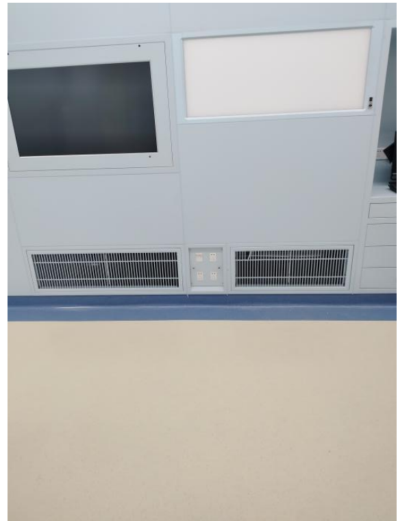
图 4-16 机房内北侧墙下方排风口
