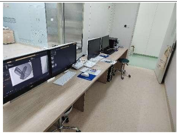
图 3-4 南侧控制室内景
