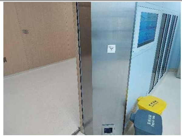
图 3-16 机房防护门红外防夹装置
