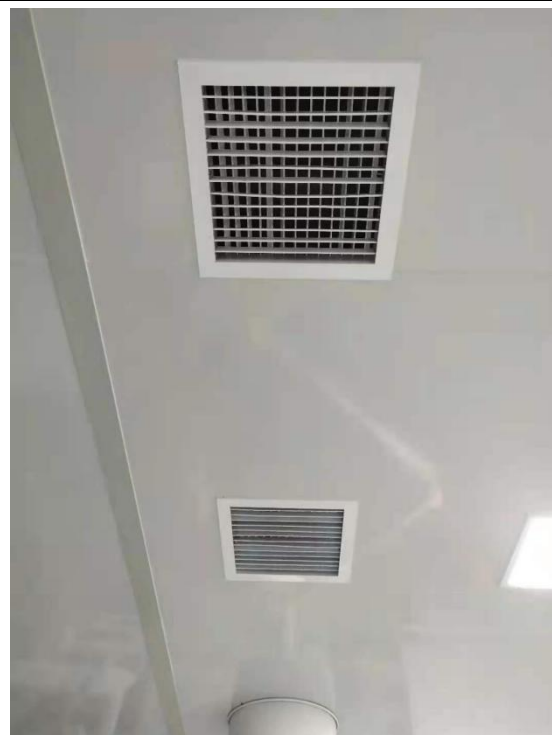
图 3-8 机房顶部排风口
