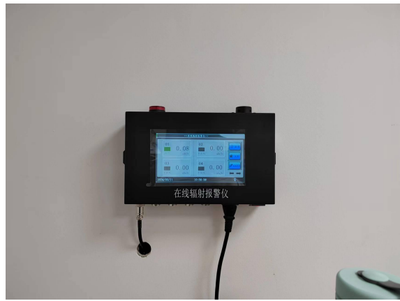
控制室固定式辐射监测报警仪主机
