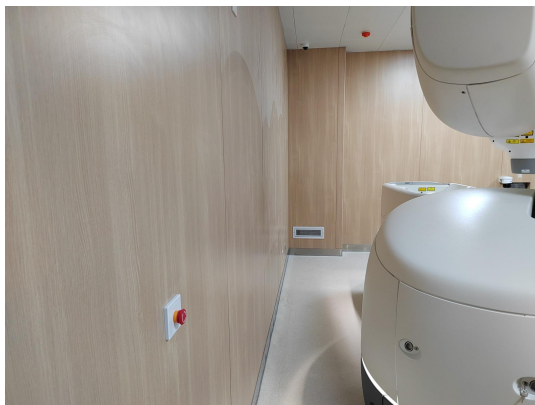
南墙急停开关、西南角排风口
