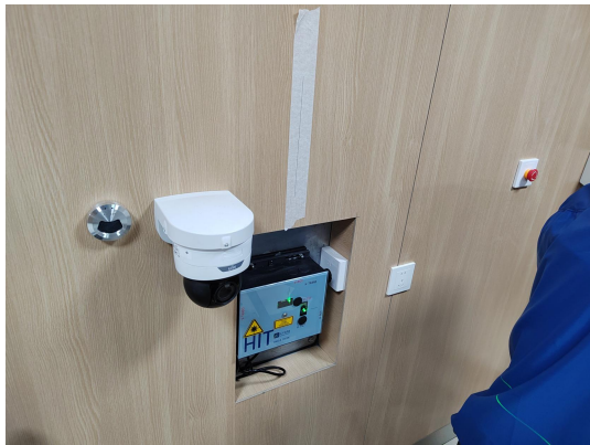
东墙摄像头、急停开关
