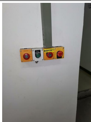
图 3-1-8 探伤室内急停按钮及 说明
