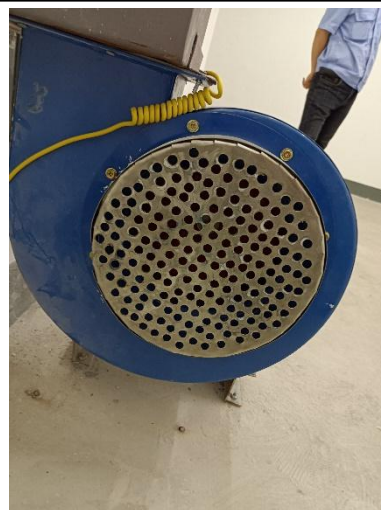
图 3-1-14 探伤室内排风口
