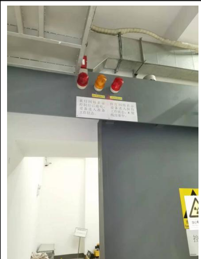
图 3-1-6 铅防护门(含室外状 态指示灯和声音提示装置)
