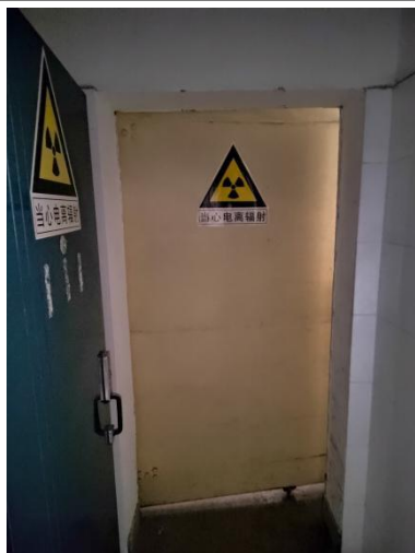
图 4-4 X 射线探伤机存放间
