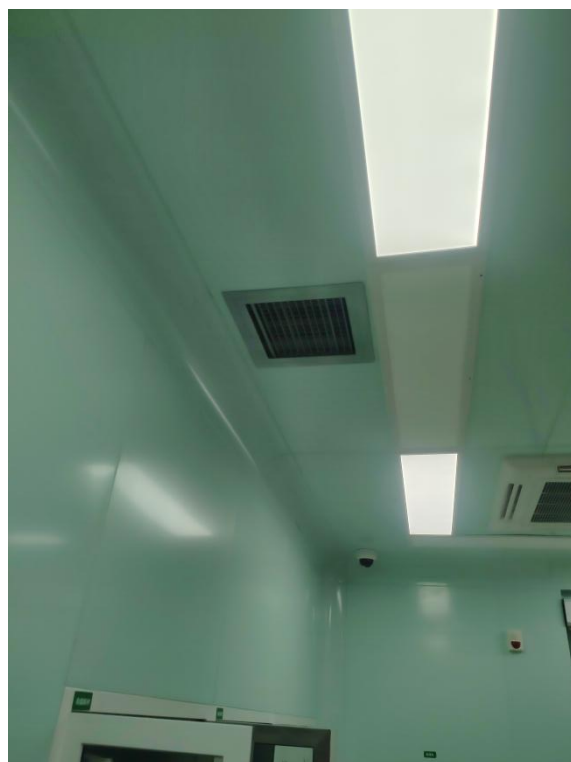
图 4-8 机房内摄像监控装置
