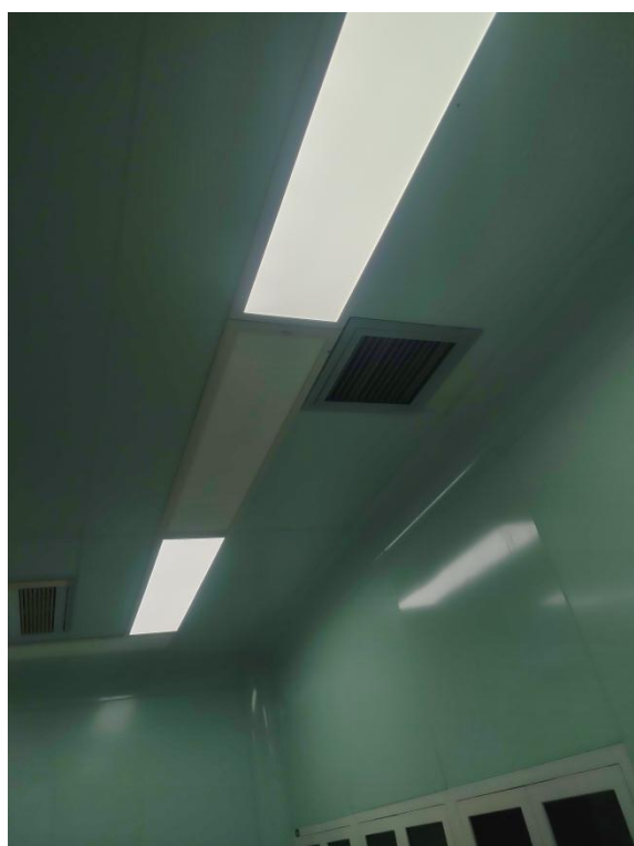
图 4-11 机房内排风口
