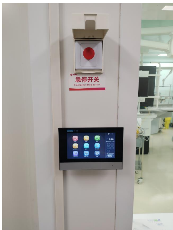
图 4-9 控制室墙上急停开关
