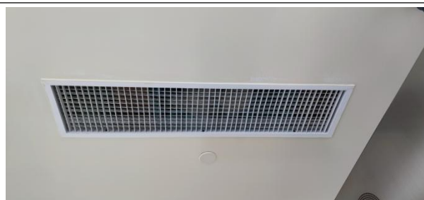
图 4-20 分装室排风口
