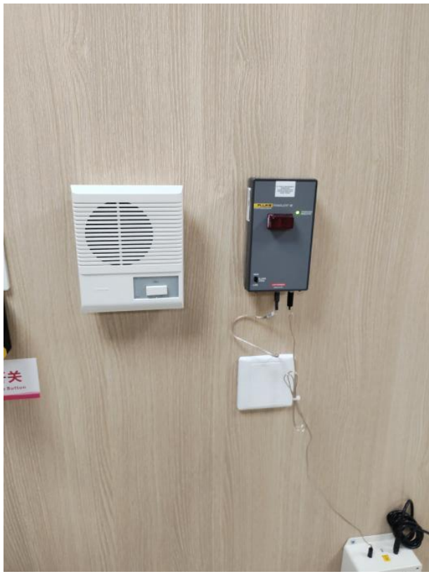
图 4-5 机房内对讲装置
