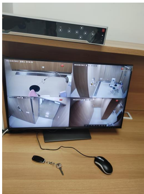
图 4-2 控制室内监控显示屏及防护门遥控
