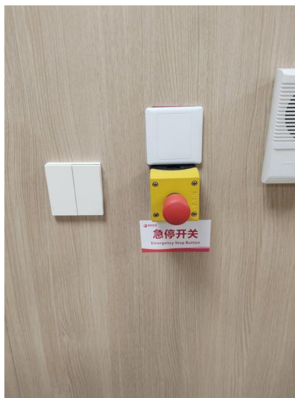
图 4-4 机房内急停开关
