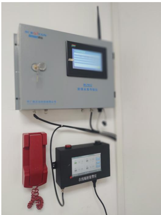
图 4-7 控制室内辐射监测仪主机
