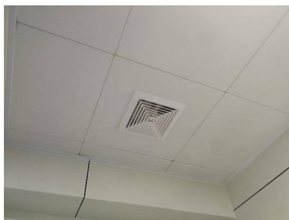
图 3.2 机房内通风装置
