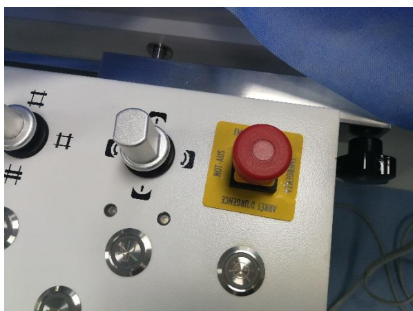
图 3.5 机房内急停装置
