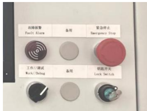
图 7-20 控制柜紧急停机按钮
