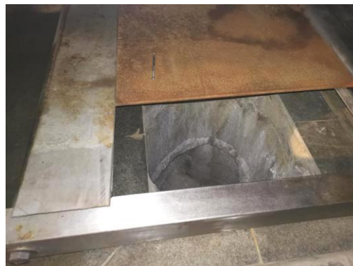
图 7-12 辐照室内排风口(机头正下方地面)
