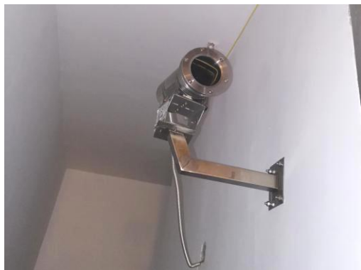
图 7-11 辐照室内摄像监控装置
