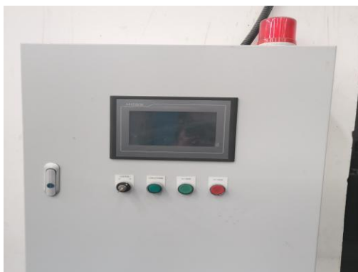
图 7-7 辐照室外钥匙开关
