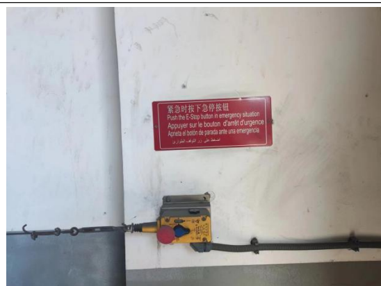
西查扫描大厅内急停按钮
