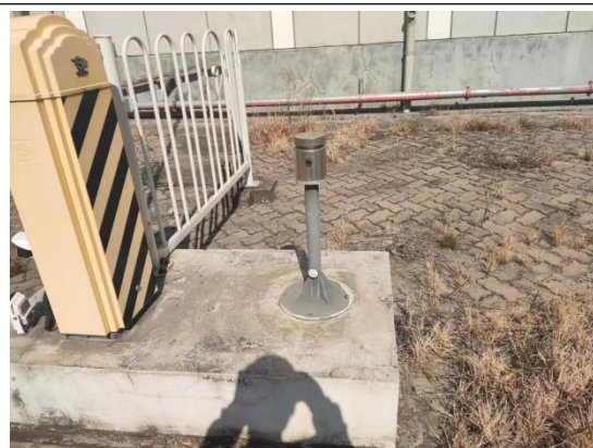
西查扫描大厅入口处红外感应装置
