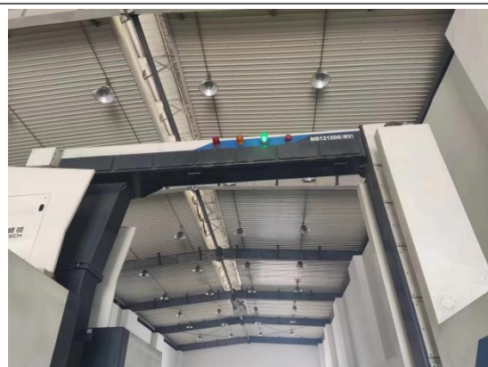
西查扫描大厅内设备运行状态警示三色灯
