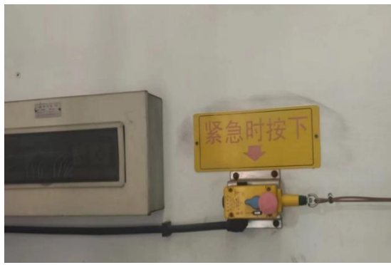
东查 1 号扫描大厅内急停按钮
