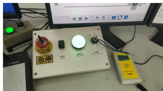
控制室控制台急停按钮及安全联锁钥匙开关
