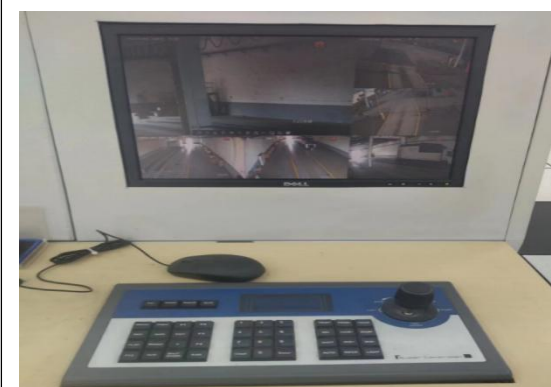
东查控制室监控设备采集装置
