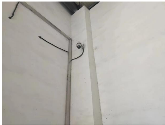
西查扫描大厅内监控设备
