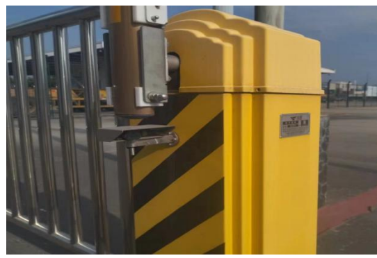
东查 1 号扫描大厅入口处红外感应装置
