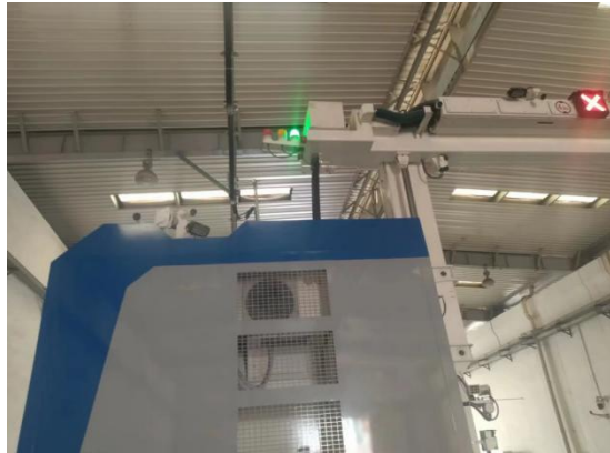
东查 1 号扫描大厅内设备运行状态警示灯
